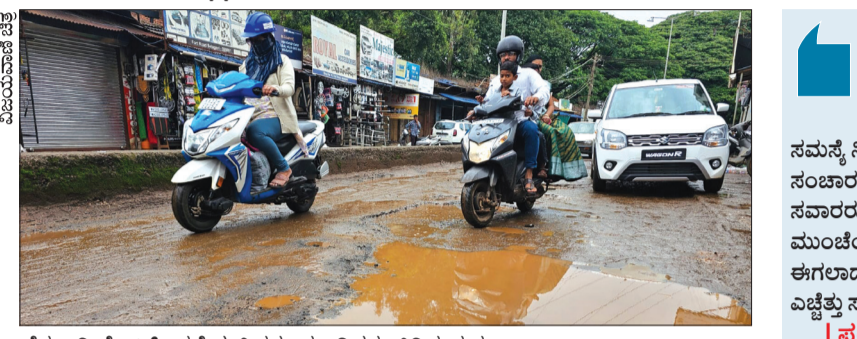
ಬೆಳಗಾವಿ ಪೋರ್ಟ್ ರಸ್ತೆಯಲ್ಲಿ ತಗ್ಗು-ಗುಂಡಿಗಳು ಬಿದ್ದಿರುವುದು. ಅದಕ್ಕೂ ಮೊದಲು ಕಳೆದೊಂದು ವಾರದಿಂದ ಹಲವು ಅವಾಂತರ ಸ್ಪಷ್ಟಿಸಿದೆ. ಗಾಂಧಿ ನಗರ ಸುರಿಯುತ್ತಿರುವ ಪೂರ್ವ ಮುಂಗಾರು ಮಳೆಯು ಬಳಿಯ ಸರ್ವಿಸ್ ರಸ್ತೆಯಲ್ಲಿ ಪ್ರತಿ ವರ್ಷವೂ ಗುಂಡಿಗಳು ಬೀಳುತ್ತವೆ. ಅದರೂ ಲೋಕೋಪಯೋಗಿ, ಮಹಾನಗರ ಪಾಲಿಕೆ ಸೇರಿ ಸಂಬಂಧಿಸಿದ ಅಧಿಕಾರಿಗಳು ನಿರ್ಲಕ್ಷ್ಯ ವಹಿಸುತ್ತಾರೆ. ಒಂದು ತಿಂಗಳು ಮೊದಲೇ ರಸ್ತೆ ದುರಸ್ತಿಪಡಿಸಿದ್ದರೆ ನಮಗೆ ಈ ಪರಿಸ್ಥಿತಿ ಬರುತ್ತಿರಲಿಲ್ಲ ಎಂದು ನಾಗರಿಕರು ಪ್ರತಿಪತ್ತಿಯನ್ನು ವ್ಯಕ್ತಪಡಿಸಿದ್ದಾರೆ. ನಗರದ ಹೆಚ್ಚಿನ ಮಾರುಕಟ್ಟೆ ಬಳಿ, ಪೋರ್ಟ್ ರಸ್ತೆ, ಅಯ್ಯೋದೈ ನಗರ, ಸದಾಬಾದೆ ನಗರ, ಎಪಿಸಿ ರಸ್ತೆ, ಅಂಜಿ ಕಚೇರಿ
